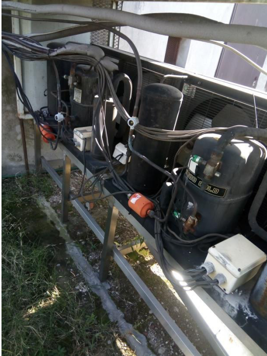
Fig: Compresores existentes 2 de 5,25kW
