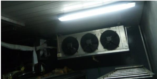
Fig: Ventiladores existentes en cámara frigorífica
