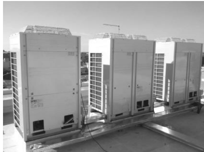
Foto: Disposición de unidades condensadoras VRV de armado modular.
