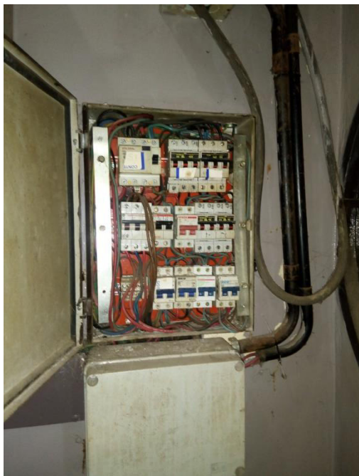
Fig: tablero seccional con salidas existentes
