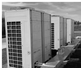
Foto: protección mecánica de cañerías al exterior.
