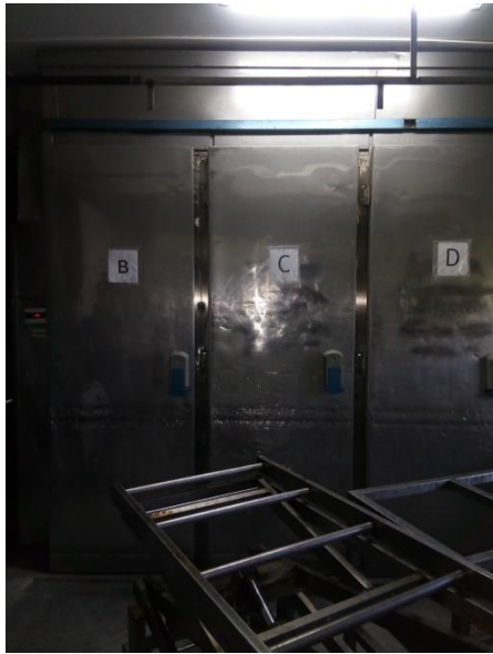
Fig: Cámara existente
